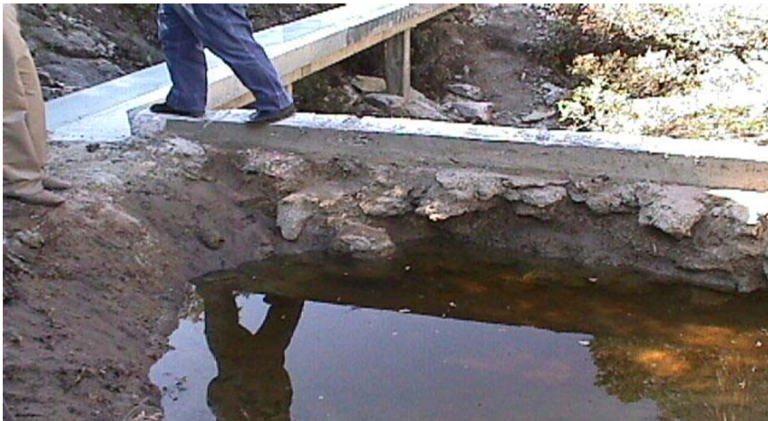
Anexo 3. Fosa de captación y de sedimentación, con vertedor de demasías (arriba a la izquierda), conectando con el canal de conducción de agua.
